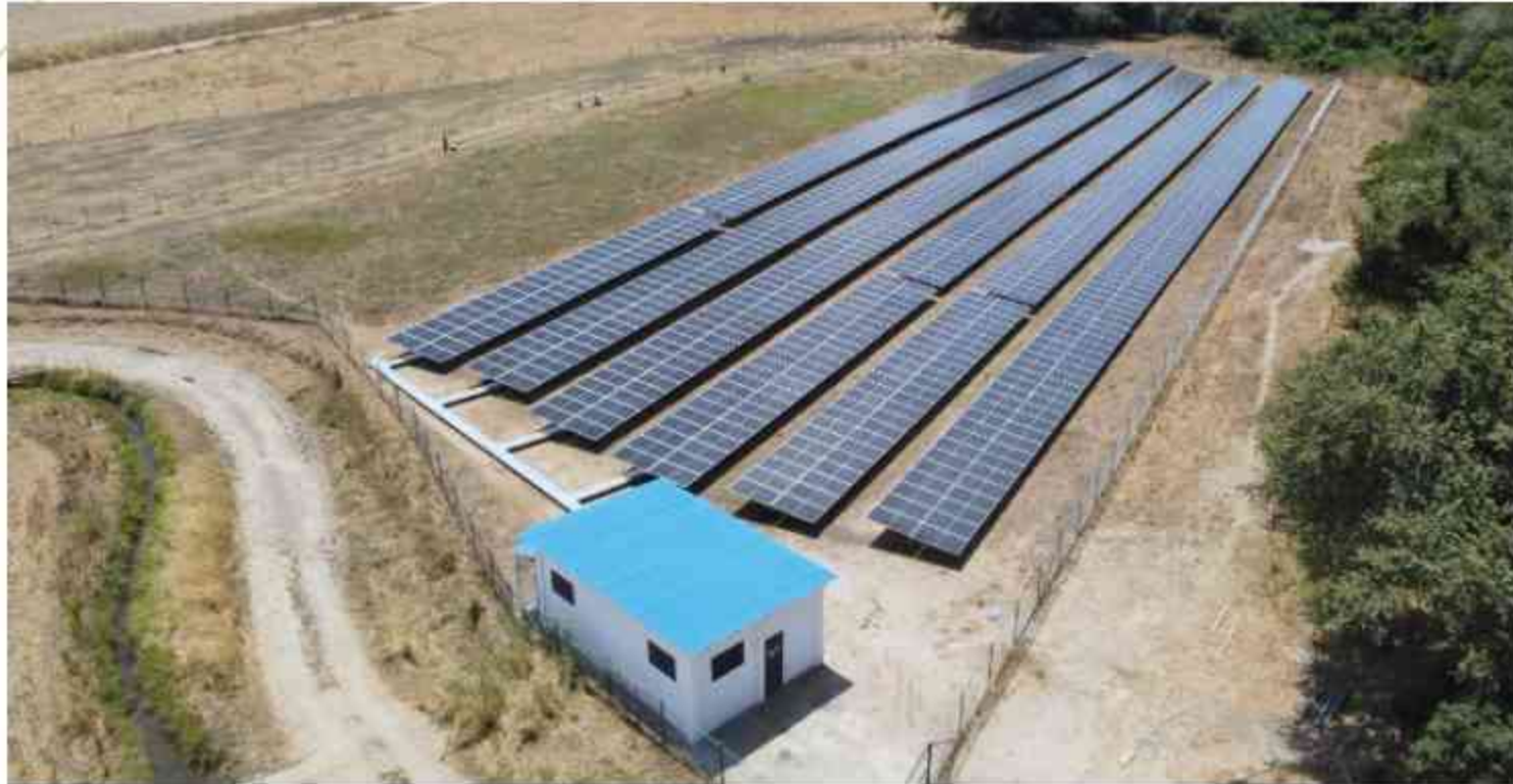
Arrocera Boluga - 1250 paneles - 750 Kwp - Venadillo Tolima
