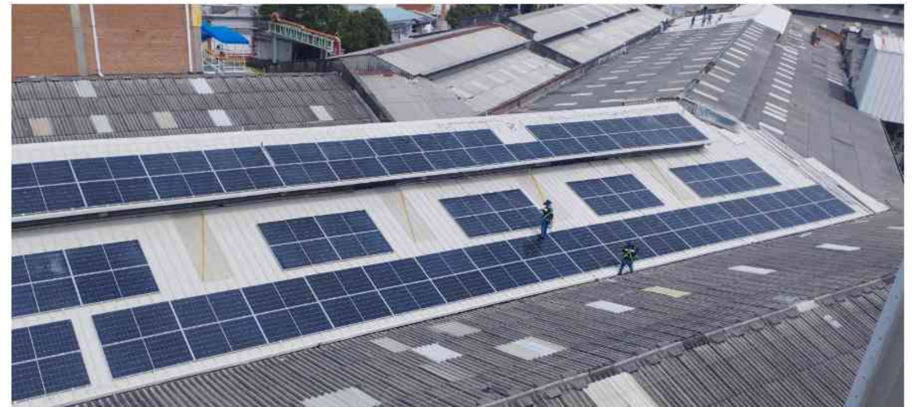
Colgate Palmolive - 1266,8 kWp - Cali - Valle del Cauca.
