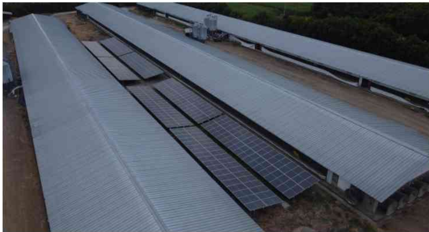
LP Villegas - 264 paneles - 158,4 Kwp - Cali Valle del Cauca
