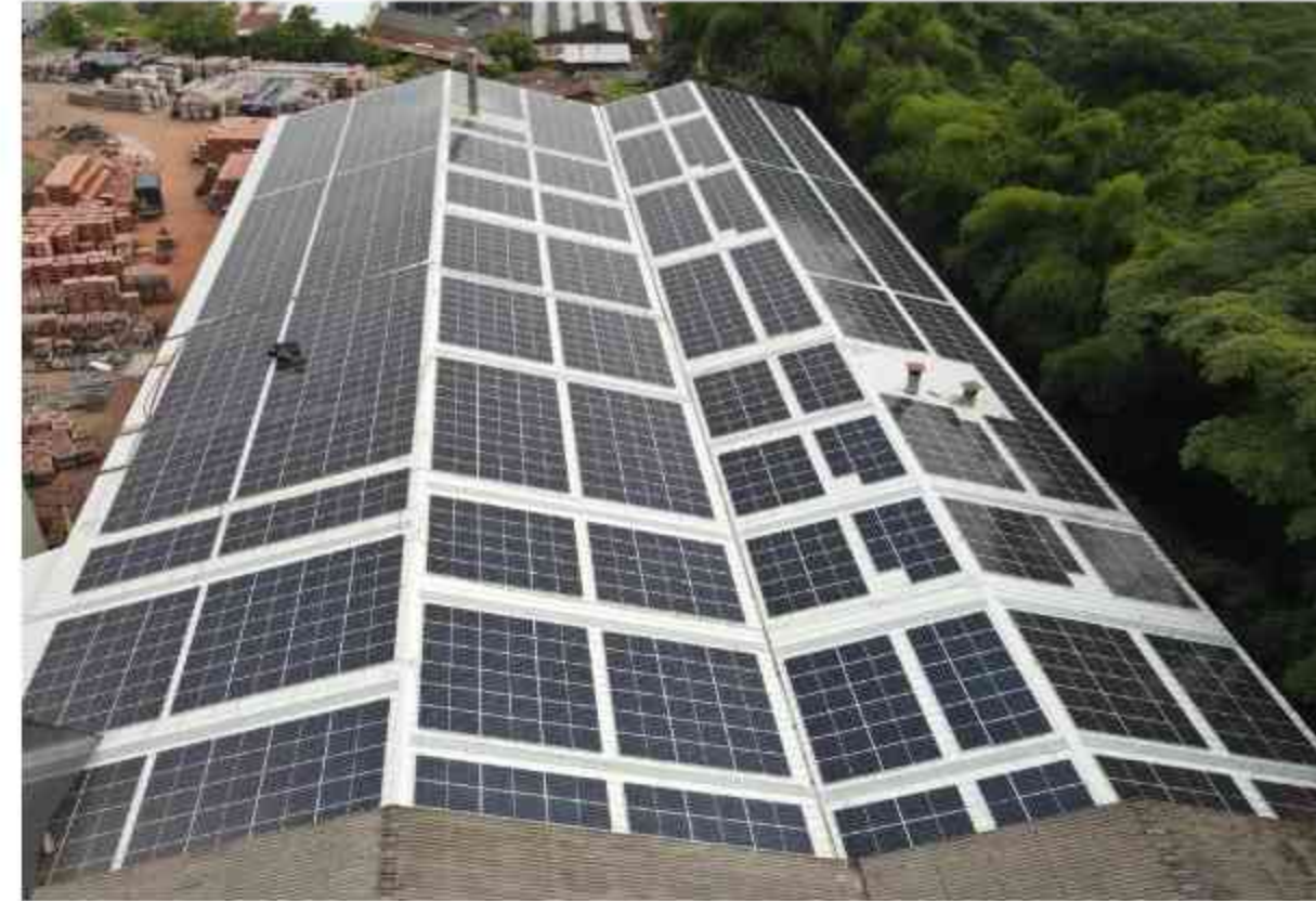
Casa Gres, 1455 paneles - 800.25 Kwp - Manizales Caldas
